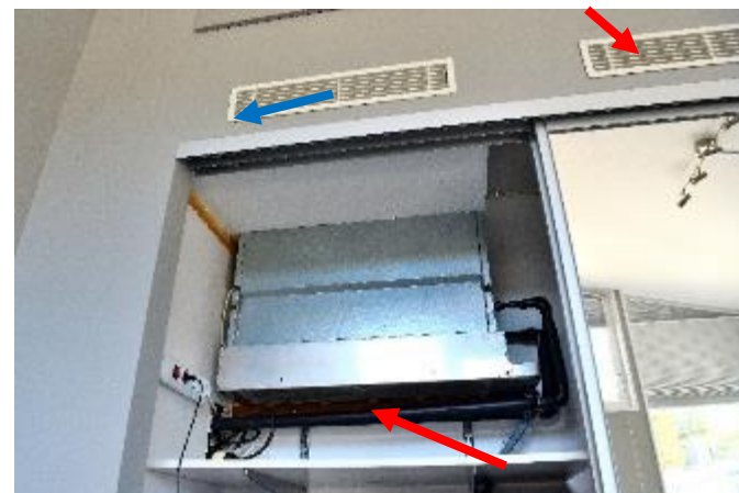
En fläktluftkylare har installerats i sovrummets garderob.
